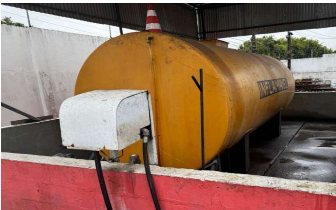
Figura 2 "Tanque de diesel de 15.000 litros, ideal para armazenamento de combustível em grande escala, com sistema de vedação e proteção contra vazamentos".
