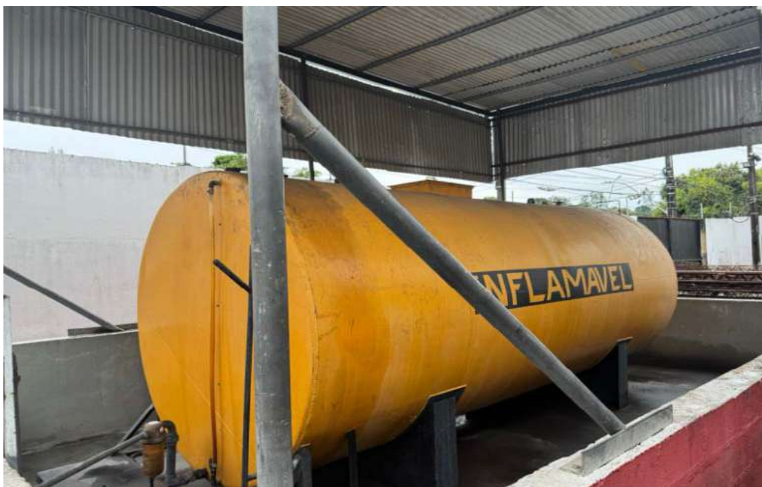
Figura 1 "Tanque de armazenamento de diesel com capacidade de 15.000 litros, projetado para garantir segurança e eficiência no abastecimento de veículos e maquinários".
